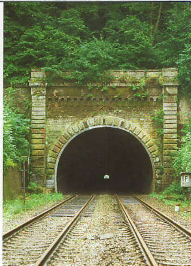
Der Weinsberger Tunnel vor dem Umbau, von Weinsberg her gesehen. Dieser Durchstich war lange umkämpft.
